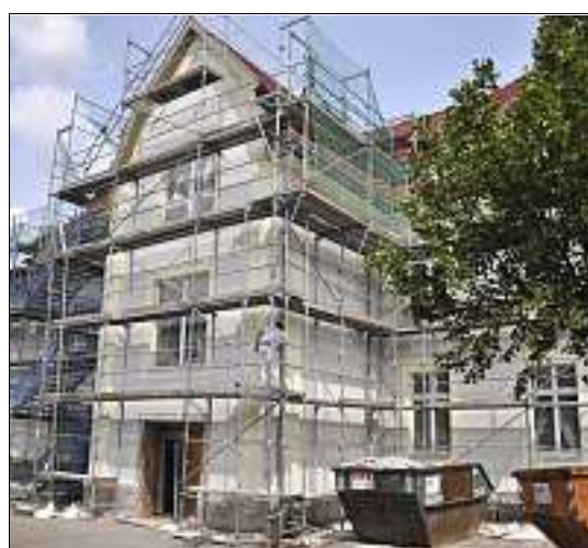
Das Gerüst an der neuen Schule in Herbsleben wird kommende Woche abgebaut. Foto: Mara Mertin
